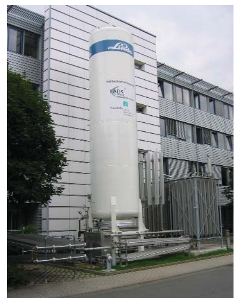
Stickstoffversorgung mit Förder-, Misch- und Regelungssystem
